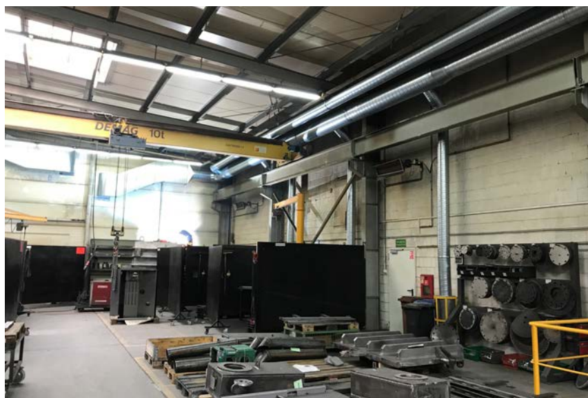
Rys. 2. Widoczne orurowanie pionowe
