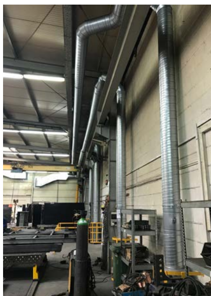
Rys. 3. Gęste ułożenie rur nawiewowych
